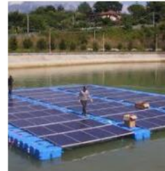
Système solaire photovolt... nrgisland.com
